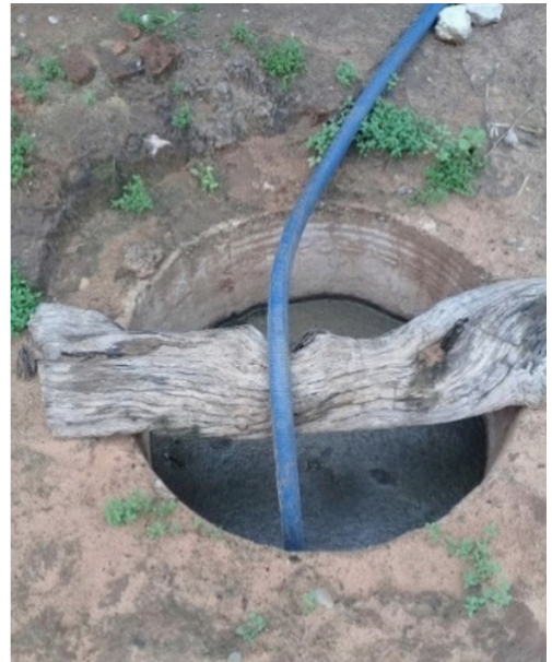
Imagen 1. Fosa temporal de almacenamiento de efluentes
