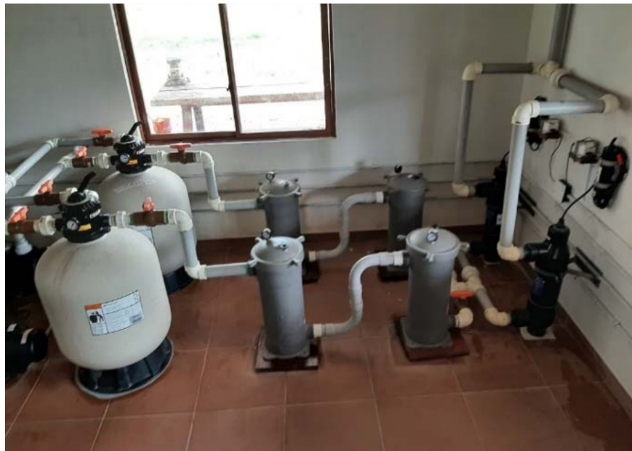
Anexo 4 Filtros del sistema RAS.
