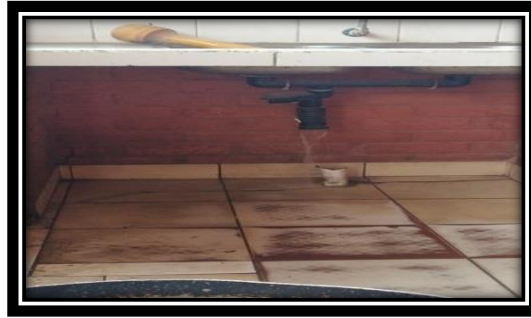
Cañería en mal estado.
