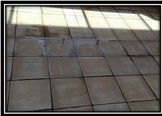
piso con presencia de agua
