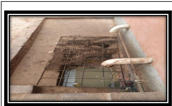
Rejilla de drenaje en mal estado.
